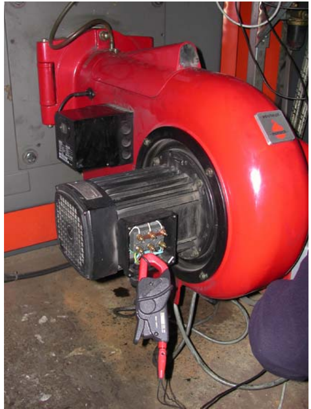
Weishaupt - Brenner mit Stromzange
