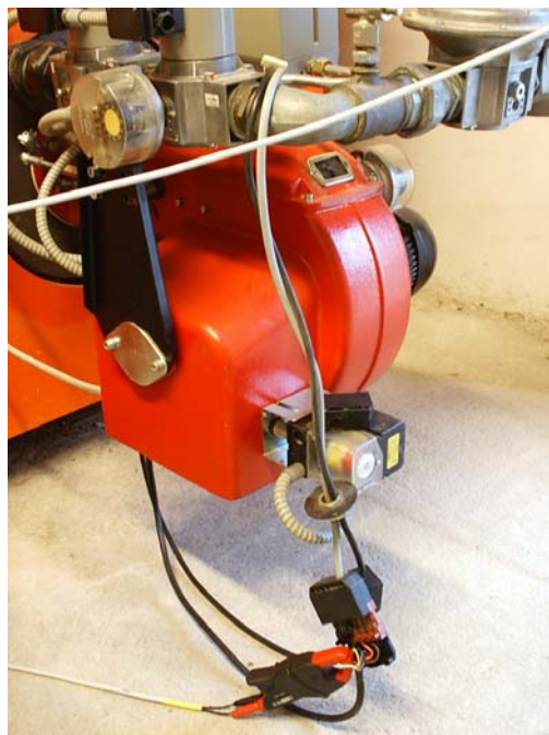
Messung der Stromaufnahme des Brenners
