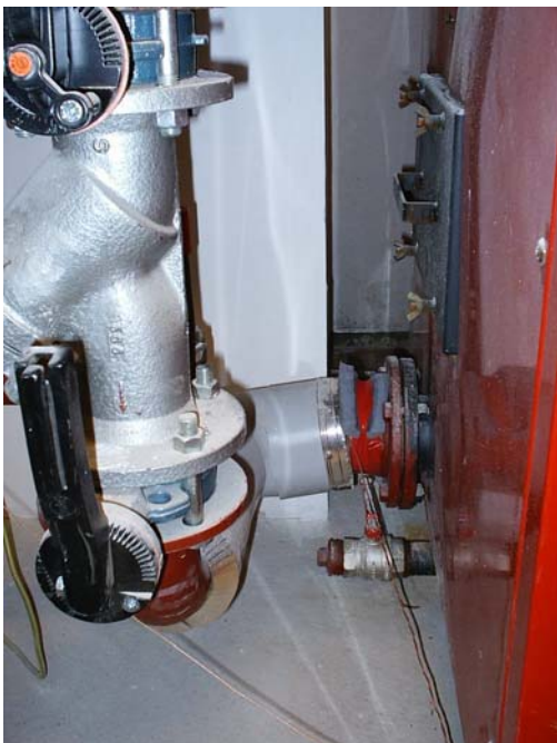
Temperaturmessung am Rücklauf HK
