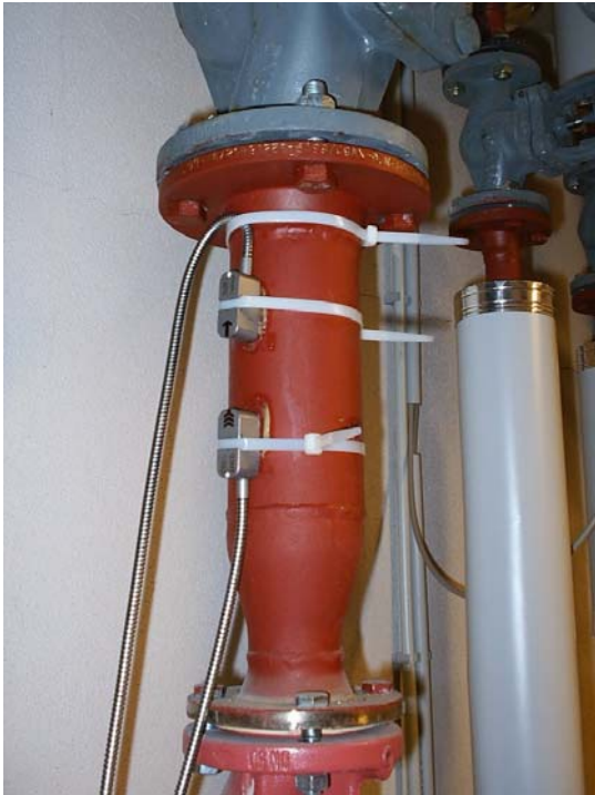
Messung des Volumen - Durchflusses Wasser
