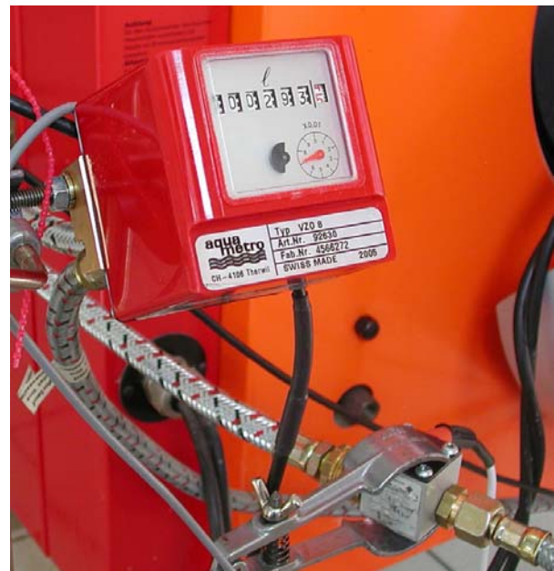
Öl - Zähler im Vorlauf und Rücklauf
